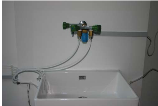
Abbildung 32: Wasserhauptanschluss für die beiden Kühlkreisläufe
